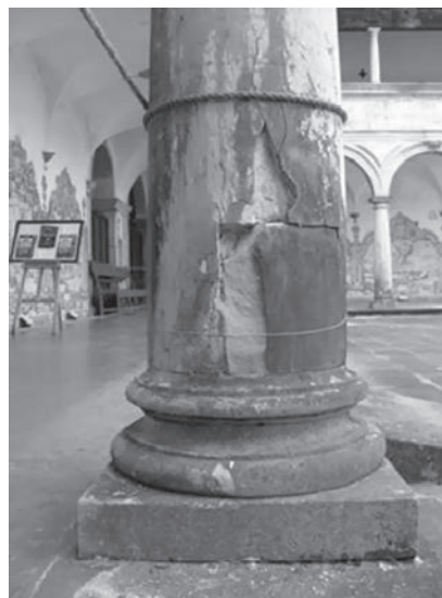
Figura 3 – Coluna com fortes sinais de degradação
