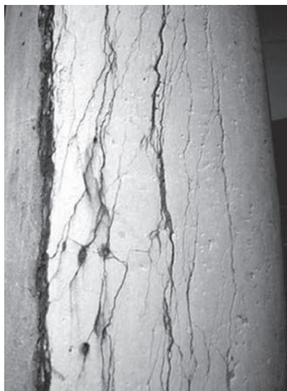
Figura 4 – Fissuração do material ao longo dos leitos de pedra
