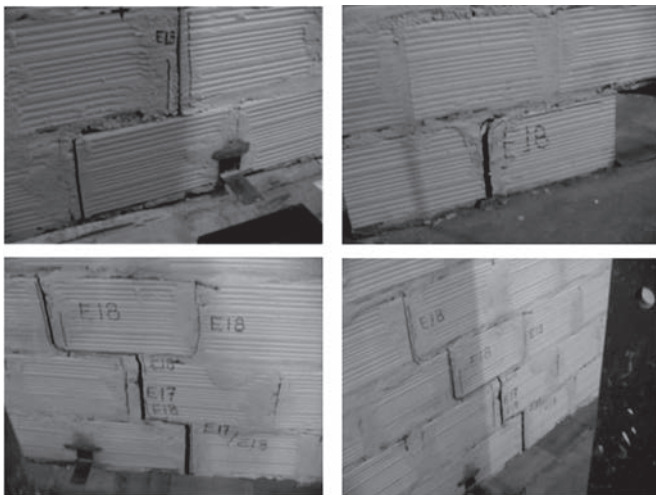
Figura 9 – Detalhes da lagura das fissuras da mini parede 2 da Série 1.
