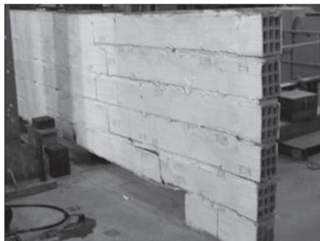
Figura 10: Modo de ruptura da mini parede 2 da Série 3.
