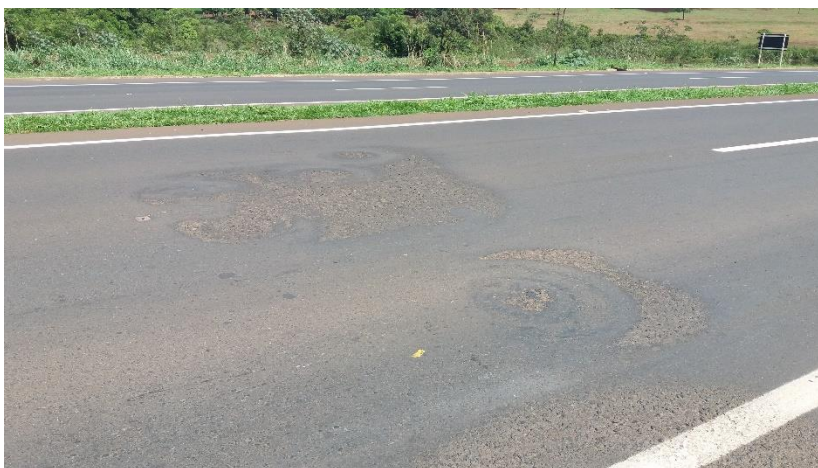
Figura 9: Desgaste superficial encontrado na rodovia
