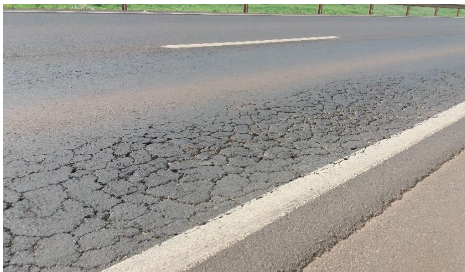
Figura 5: Trinca couro de jacaré.
