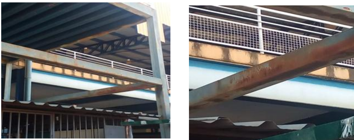
Figura 2: Detalhe - corrosão em viga de aço. Figura 3: Conjunto de vigas deterioradas
