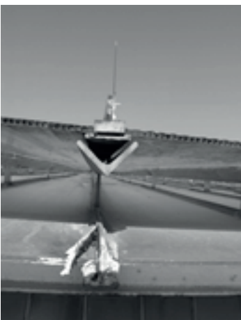
Figura 5: Degradação da estrutura metálica do Pátio das Nações e da proteção complementar aplicada.
