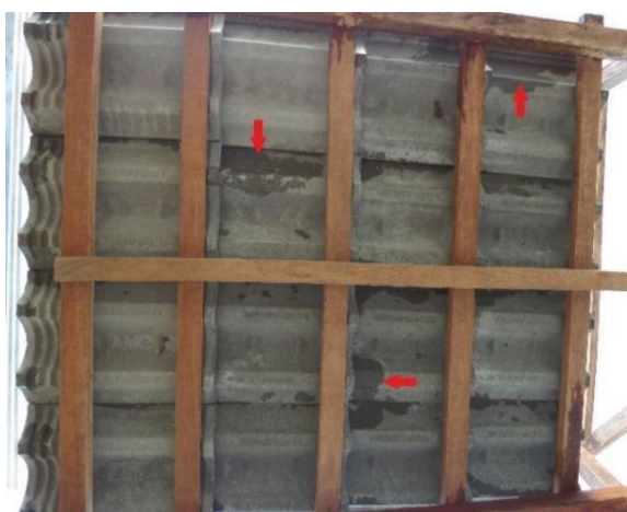
Figura 15: Inspeção visual na face inferior das telhas após 2h de ensaio.
