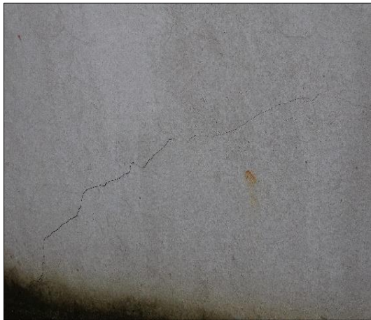
FIGURA 5: Fissura inclinada à 45° na parte externa da obra.
