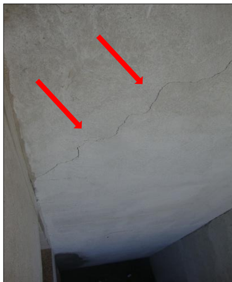
FIGURA 3: Trinca inclinada 45° na caixa de escada, devido ao recalque na fundação.
