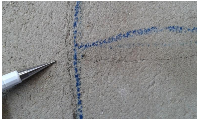
(c) detalhe das fissuras após o 10º ciclo
