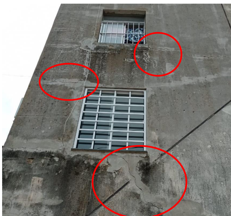
Figura 6: Fissura Aberta em Vão
