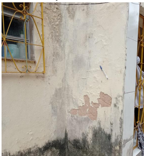
Figura 3: Descolamento com Empolamento em Revestimento Argamassado
