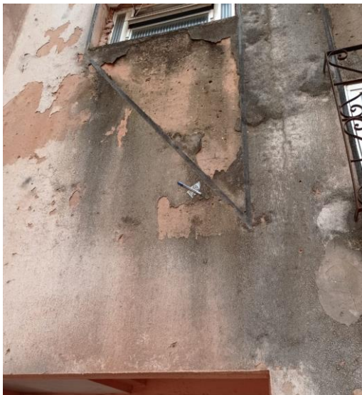
Figura 4: Descolamento com Pulverulência em Revestimento Argamassado
