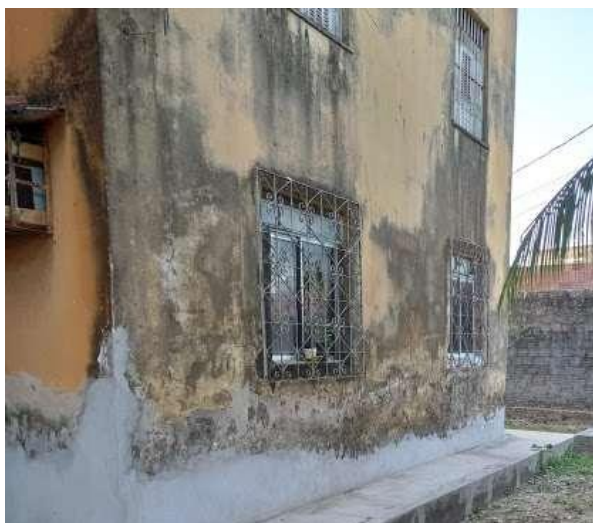
Figura 2: Revestimento Argamassado de Fachada com a Presença de Mofa
