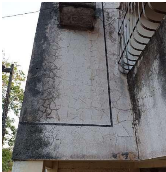
Figura 5: Fissuras Mapeadas em Revestimento Argamassado
