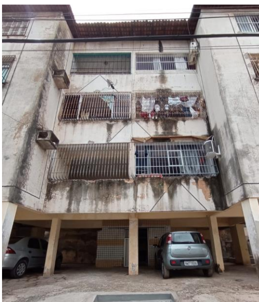
Figura 1: Manchas de Umidade nas Fachadas do Condomínio
