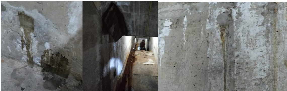
Figura 15, 16 e 17: Infiltração na estrutura
